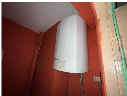
Elektriskais ūdens boileris
