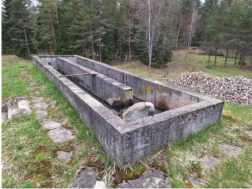
Notekūdeņu attīrīšanas iekārtas (kadastra apzīmējums 9417 001 0905 003)
