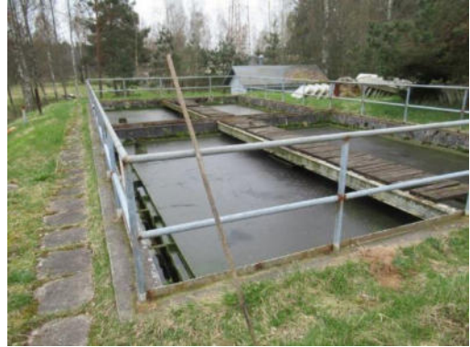
Notekūdeņu attīrīšanas iekārtas (kadastra apzīmējums 9417 001 0905 003)
