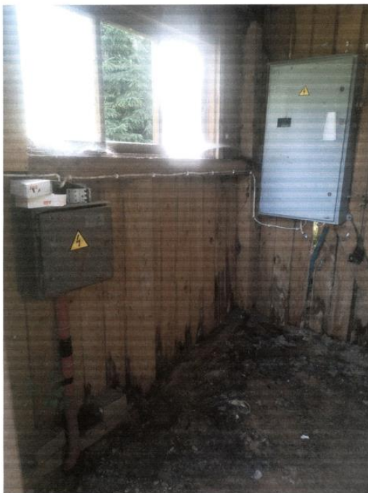
Ciema centrā 2 elektrības skapjiem pussabrukusi koka būda – jāierīko ārējā elektrosadale un būda iānoiauc
