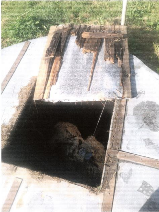
Dzeramā ūdens ņemšanas urbums ar sapuvušu koka vāku – nepieciešams montēt DN2000 pārsedzi un čuguna vāku.
