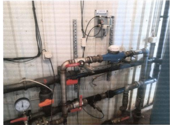
UASS ūdens ieguves mezgls – ūdens sagatavošanas stacijā ir par mazu cauru/vadu diametri, lai ciematā varētu nodrošināt ugunsdzēsību.
