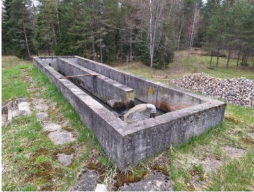
Notekūdeņu attīrīšanas iekārtas (kadastra apzīmējums 9417 001 0905 003)
