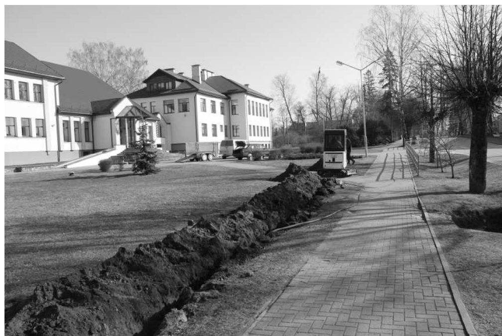
Naukšēnos jau vairākas nedēļas uz galvenās ielas diennakts tumšajā laikā nedega vairākas ielu laternas, jo pie Naukšēnu novada vidusskolas bija bojāts zemē esošais kabelis. Tagad problēmsituācija ir novērsta un Naukšēnu galvenā iela atkal ir gaiša. Paldies elektriķim Valdim Kārklīņam un Jānim Zeņķim no SIA "Trīspadsmit B" par bojājuma novēršanu.
